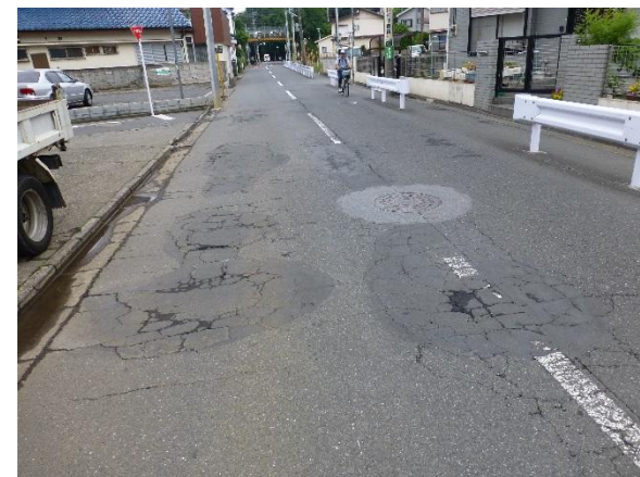
道路変状の一例
